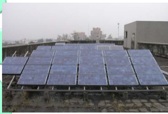
太陽能發電系統
