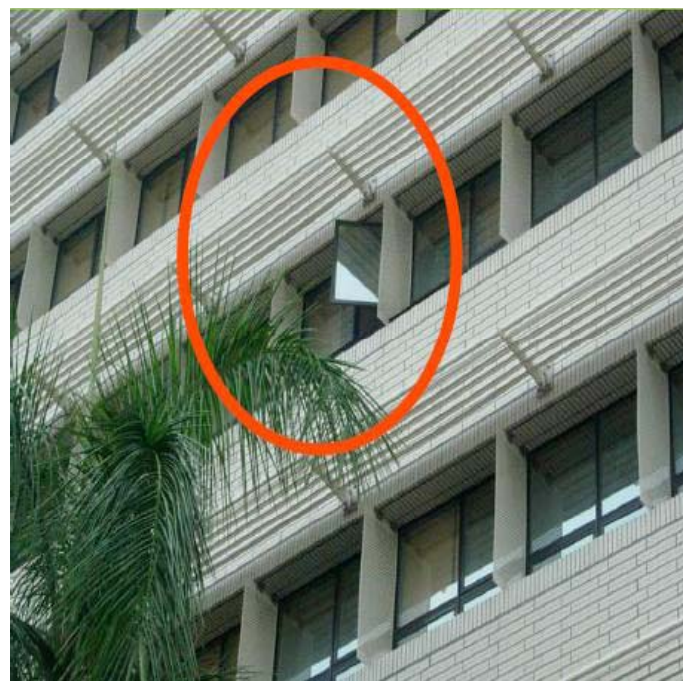
冷氣開放中，未關窗
