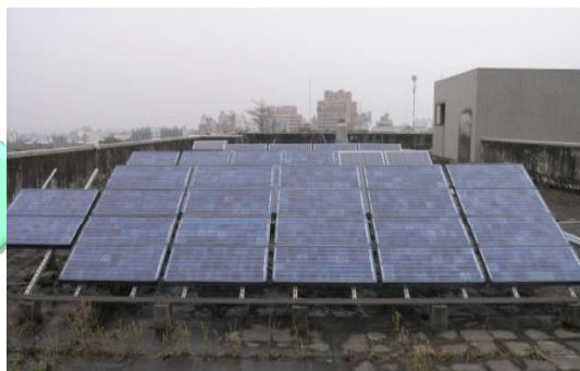
太陽能發電系統
