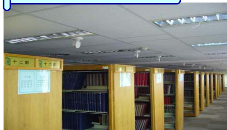
照明節能改造
